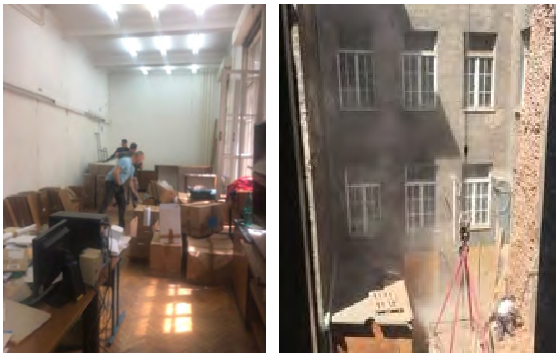
Posljedice potresa 2020. u zgradi Instituta Ivo Pilar
